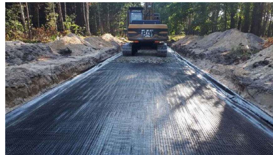
📍 Góra Śląska (woj. dolnośląskie) 📄 Georuszty PolGrid wykorzystane przy modernizacji drogi leśnej 🔲 Polgrid BX 45/45 16.680 m 2
